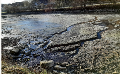
Die Spuren im Schlamm zeigen deutlich wo das Wasser durch die Bisamlöcher ausläuft.
