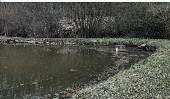
Am Mönch kann man gut erkennen, dass der Weiher ständig Wasser verliert. Selbst bei voller Befüllung ist der Wasserstand mit ca. 1,25 Meter eigentlich zu niedrig.
